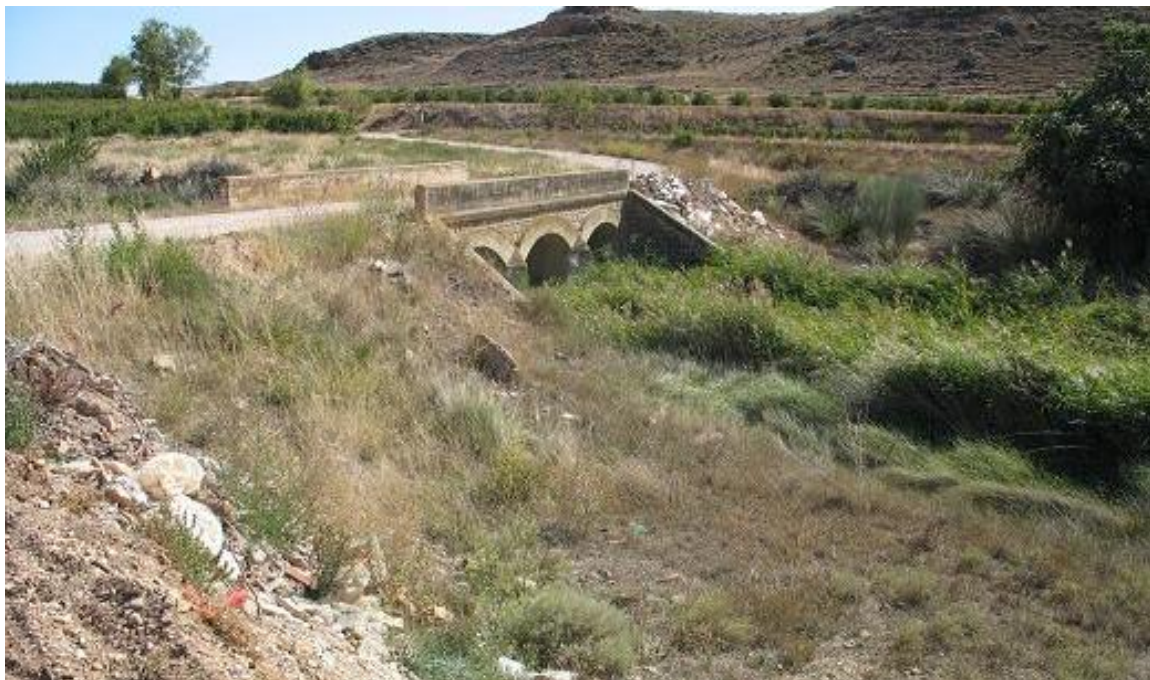
Figura 43-8. Escombrera en la orilla del río Regallo.
