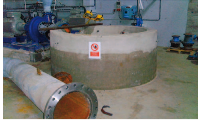
Foto 4: Pozo de abastecimiento a Calahorra. Navarra (241130002).
