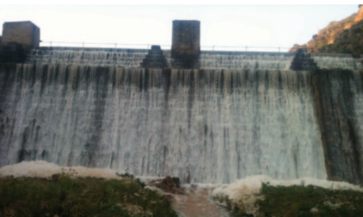
Fig 1. Presa de Añamaza en Valdegutur vertiendo por coronación.
