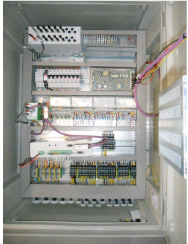
Presa de Las Torcas: Armario de centralización de lectura de los instrumentos de auscultación.
