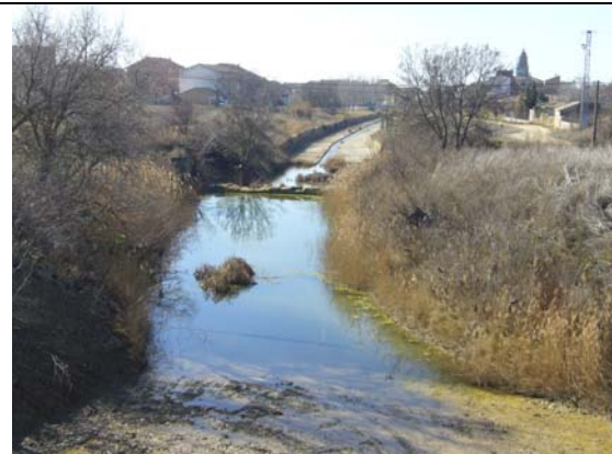
Azud de Santa María. Al fondo, Sádaba y río Arba de Riguel canalizado a su paso por dicha localidad. A la derecha se puede apreciar la colmatación y colonización de carrizos de este azud
