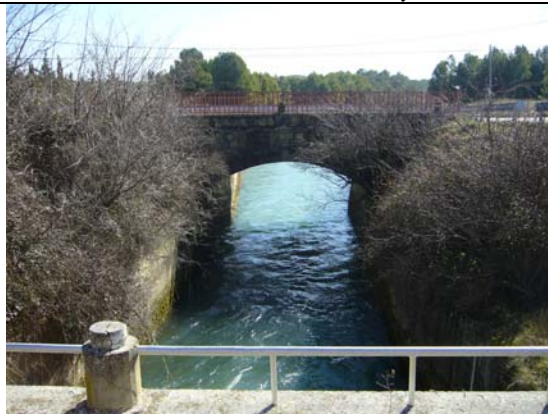
Canal de Bardenas a su paso por el norte de la localidad de Sádaba
