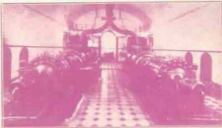
INSTALACIÓN DE LA MINA "ARRAYANES" (JAÉN) CUATRO GRUPOS DE BOMBAS 41 litros por segundo, 325 metros altura elevación. 200 HP. cada grupo. Instalación de bombas centrífugas más importante de España.
