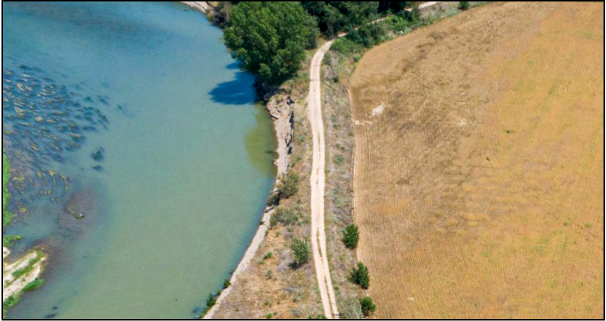
Figura 7. Estado de la defensa deteriorada en junio de 2021.
