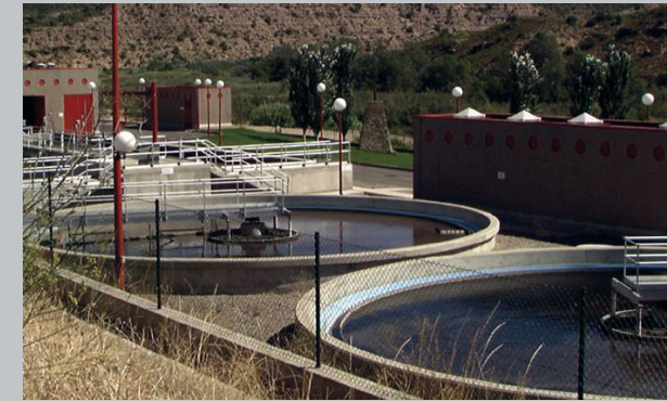
Estación Depuradora en Flix
