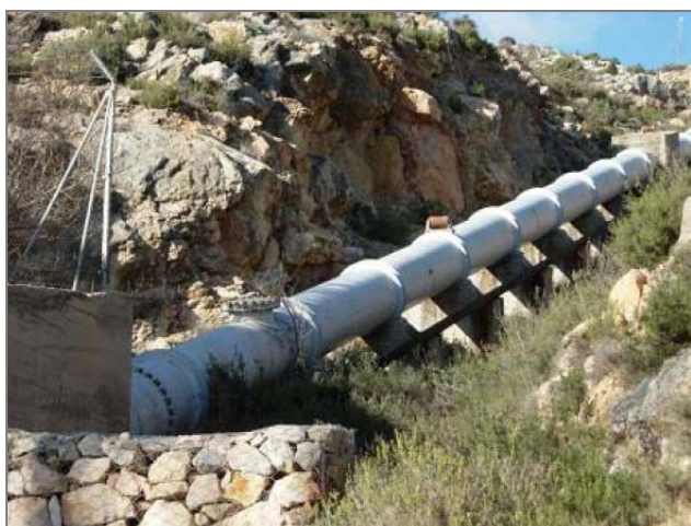
Bombeo de la central térmica de Calanda (Teruel)
