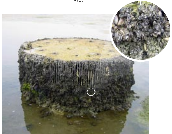
Figura 13. Detalle de una balsa de riego localizada en la cuenca del Ebro, colonizada por mejillón cebra.
